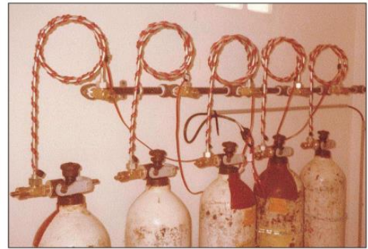
Fig. C : Raccordement de cinq bouteilles sous pression. Chauffage des flexibles indispensables
